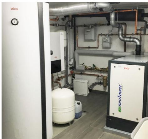
Heizzentrale mit Speicher, Brennwertkessel und BHKW
